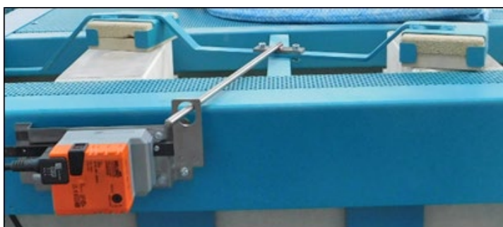
Figura 25: Compuerta automática de salida de aire
